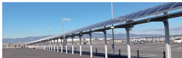
フィルム型ペロブスカイト太陽電池を搭載したバス停シェルター
