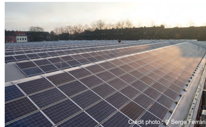
Panneaux solaires - Usine de Krefeld
