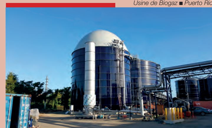
Usine de Biogaz ■ Puerto Rico
